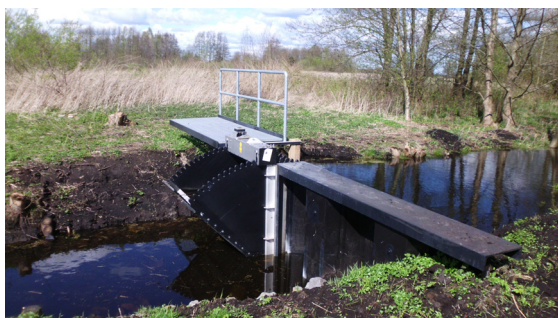
Kippwehr steuert die Wasserstände auf Naturschutzflächen – April 2014
