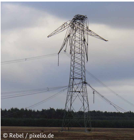
Sturmschaden durch den Orkan Kyrill im Jahr 2007
