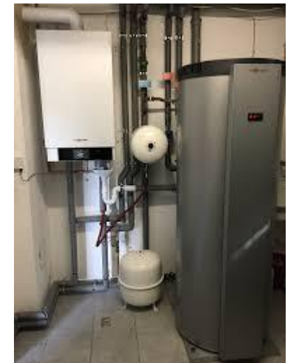
Quelle: Haustechnik Emler
