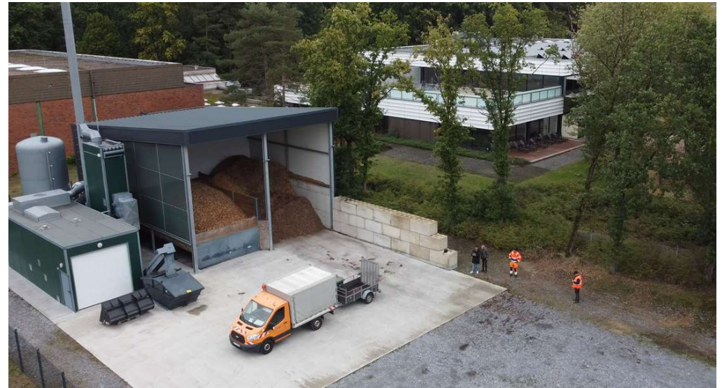
Nahwärmenetz-Holzhackschnitzelanlage © Stadt Schloss Holte-Stukenbrock
